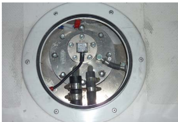
Инспекционный люк топливной системы
